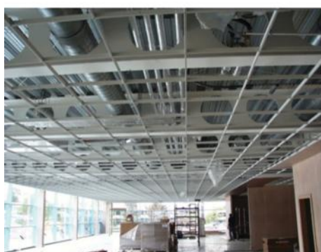
شکل 2-6 تاسیسات جا سازی شده در سقف
